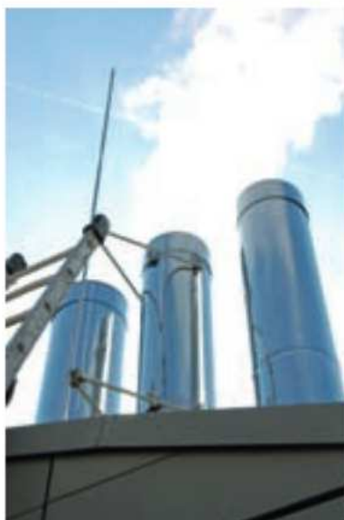
An den Schornsteinmündungen der Heizkessel (Mitte und rechts) wurde vor und nach der Schalldämpfermontage gemessen, welche Geräusche der Wärmezeuger nach draußen drangen.
