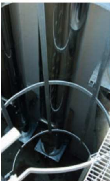
Der Zugang zu den Reinigungsöffnungen ist durch eine vergitterte Plattform möglich. Die entsprechenden Sicherungen wurden installiert.
