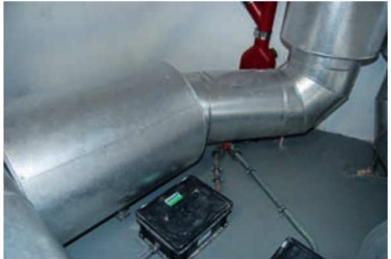
Unter der Dämmung versteckt sich in der Waagrechten ein Tiefton-Schalldämpfer und in der Senkrechten ein Passiv-Schalldämpfer.
